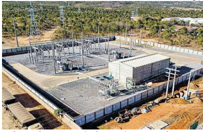
Reforços do semestre incluem três novas subestações
